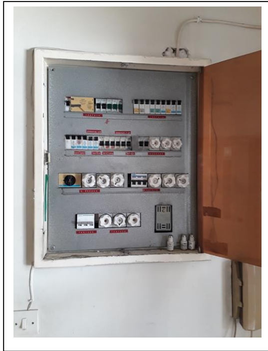
Εικόνα 9: Γενικός πίνακας κτιρίου
