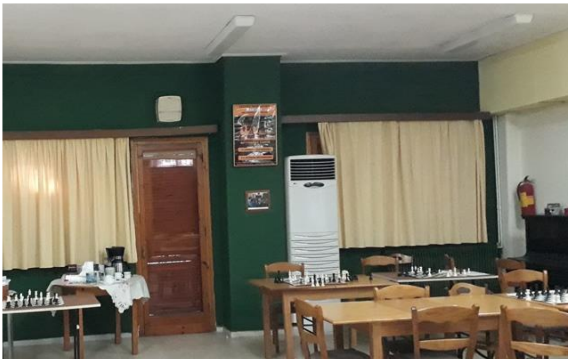
Εικόνα 8: Υφιστάμενα συστήματα κλιματισμού - εξαερισμού
