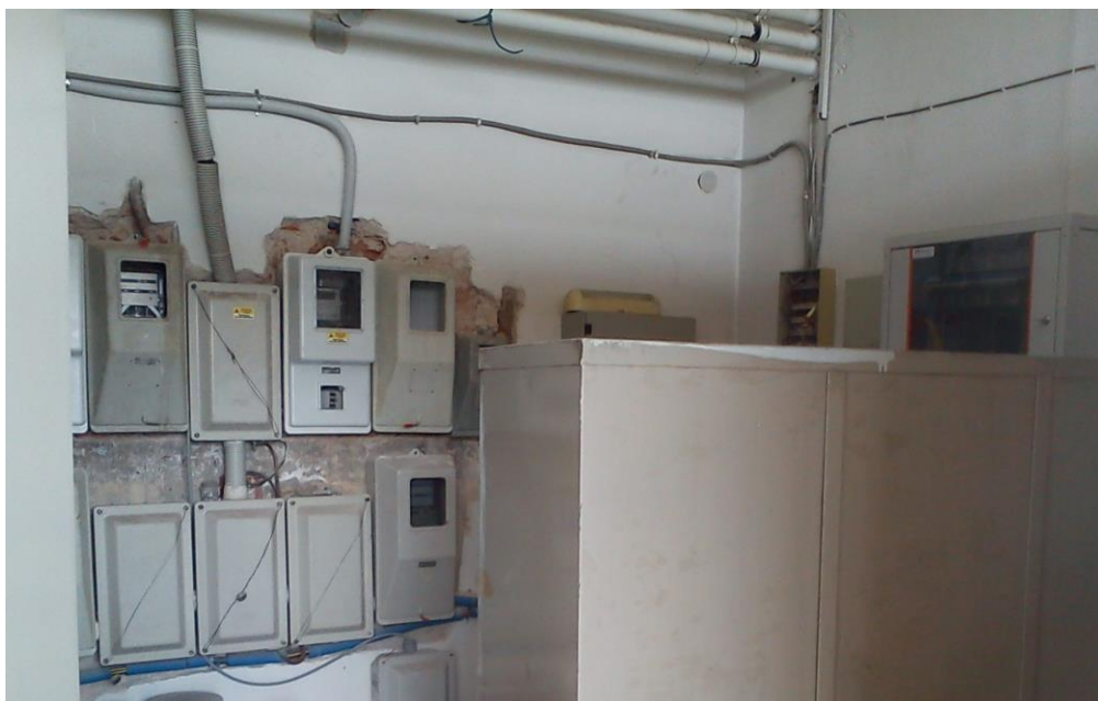
Εικόνα 8: Θέση ηλεκτρικών μετρητών στον β' όροφο
