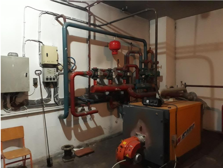
Εικόνα 13: Λέβητας παραγωγής θερμού νερού κτιρίου (πλην σχολείου)
