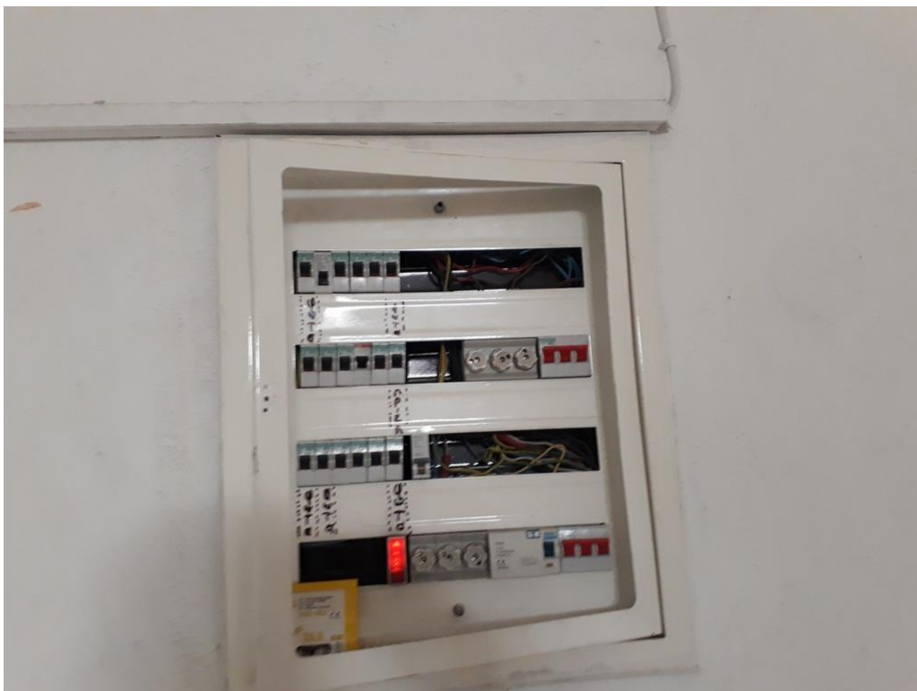
Εικόνα 10: Υφιστάμενος ηλεκτρικός πίνακας α' ορόφου
