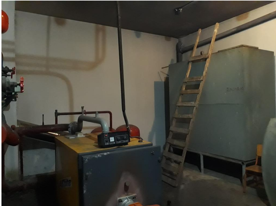
Εικόνα 14: Λέβητας παραγωγής θερμού νερού 13ου δημοτικού σχολείου
