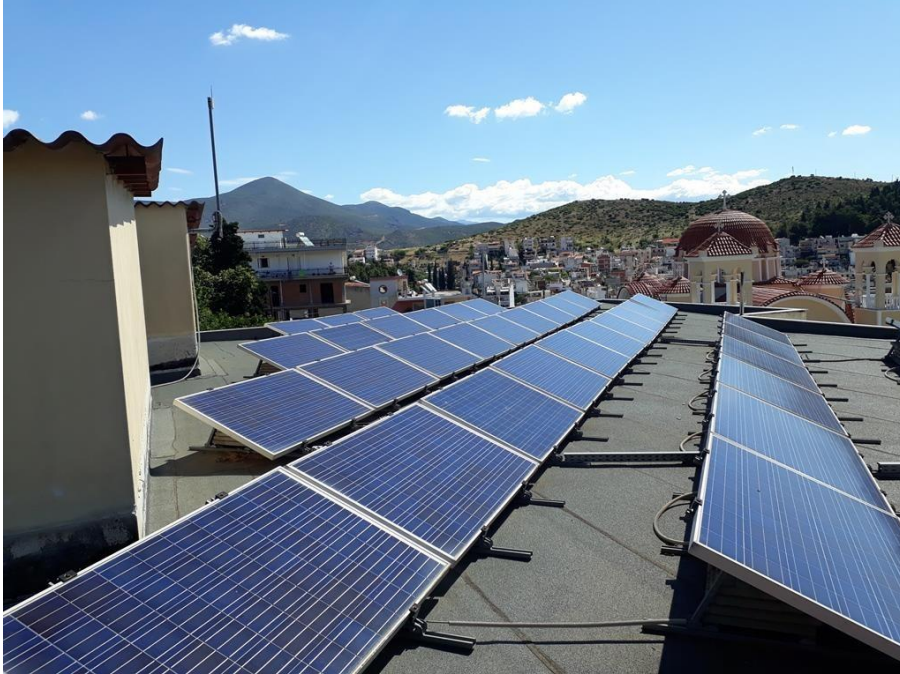
Εικόνα 15: Φωτοβολταϊκή εγκατάσταση δώματος
